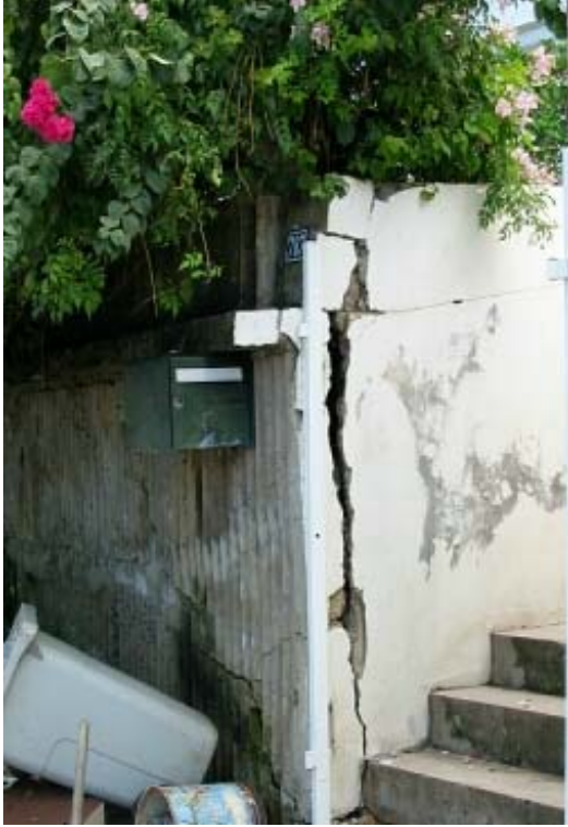
Fissures larges sur un muret à l'entrée d'une villa
