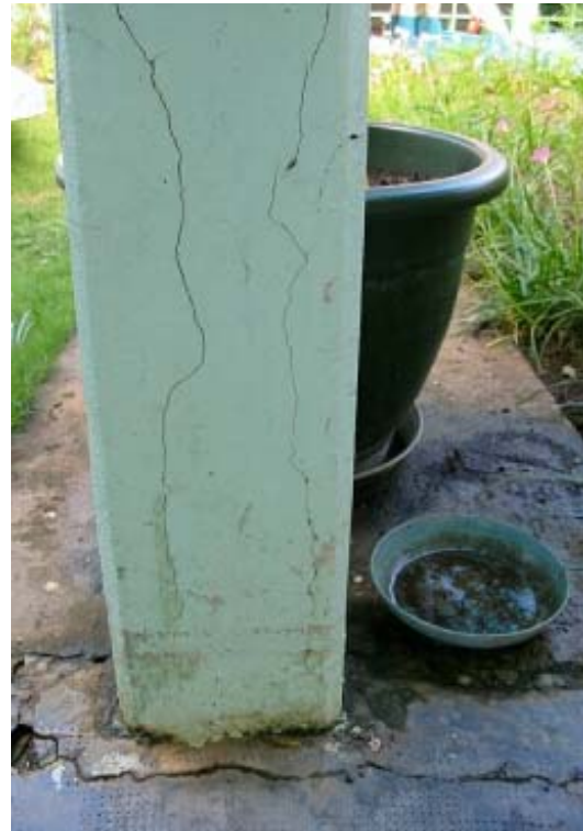
Fissures sur poteaux de la cours intérieure de l'école.
