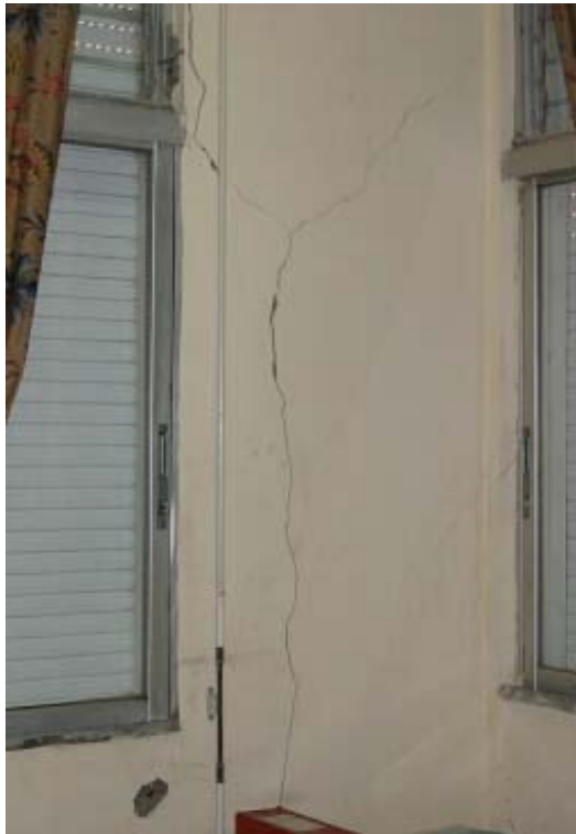
Fissures sur le mur intérieur de la mairie de Saint-Louis
