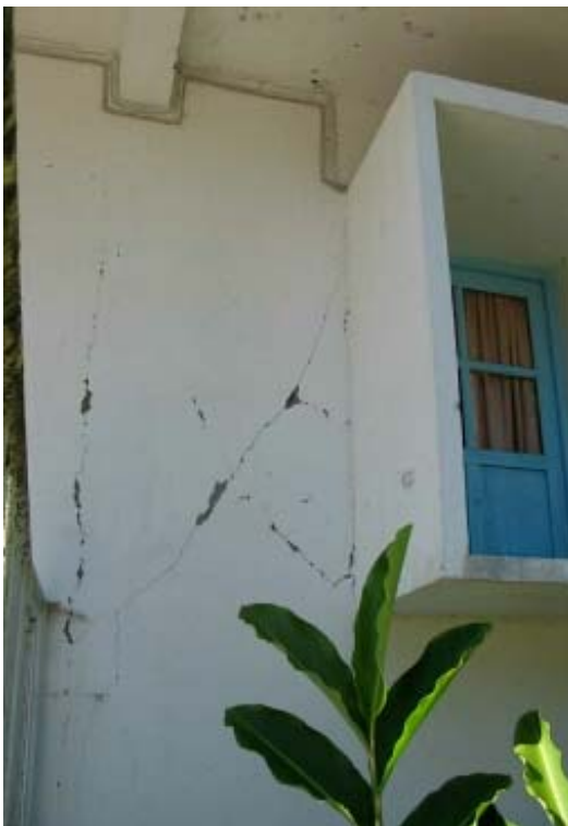
Fissures sur les murs de l'école de Matouba
