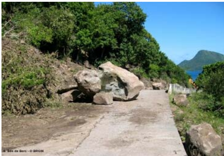
Dommmages sur la RD213, chutes de bloc
