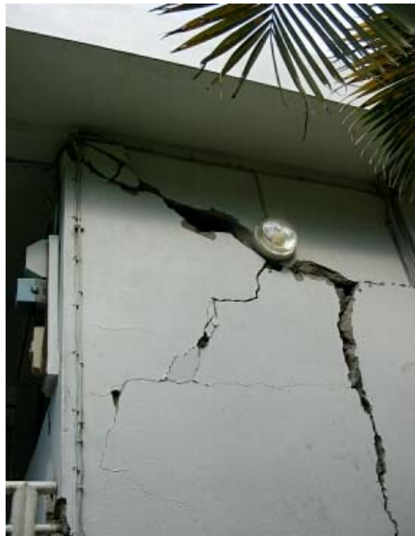
Dégâts sur une maison particulière
