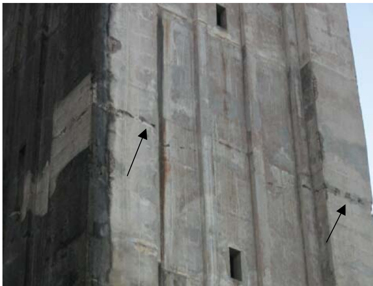
Fissures au tiers de la hauteur du clocher de l'église de Gourbeyre
