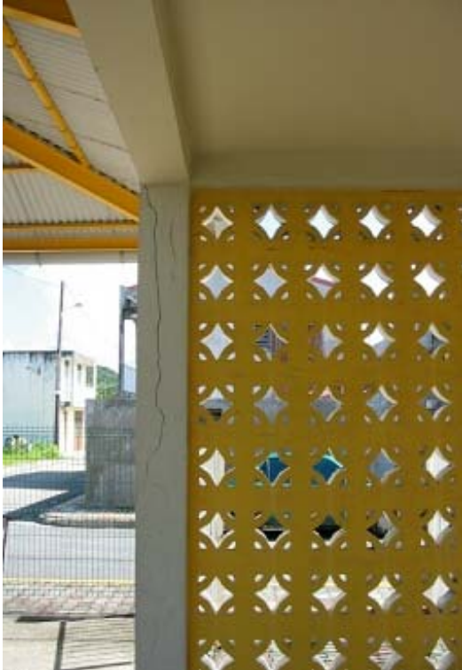
Fissures sur les poteaux en béton du marché couvert de Saint Louis
