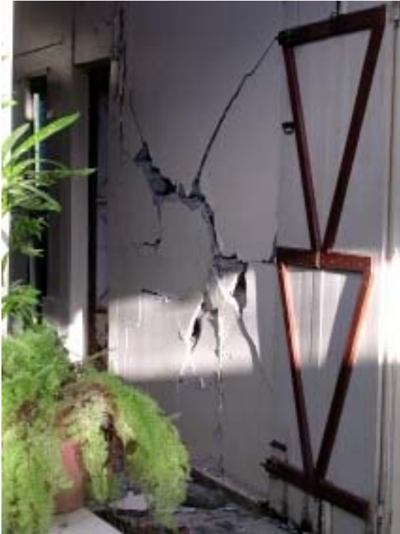
Domages sur une maison particulière
