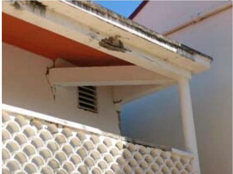
Dommmages sur une structure porteuse d'une maison au Centre Bourg
