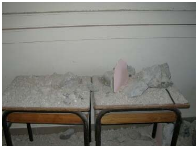
Dégâts dans une salle de classe de l'école municipale
