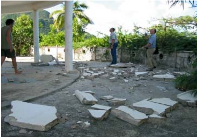
Terre de Haut Centre Bourg, chutes de blocs de béton d'une maison à étages.
