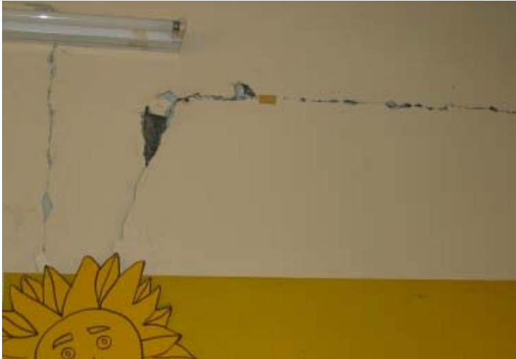
Fissures sur les murs de l'école de Matouba
