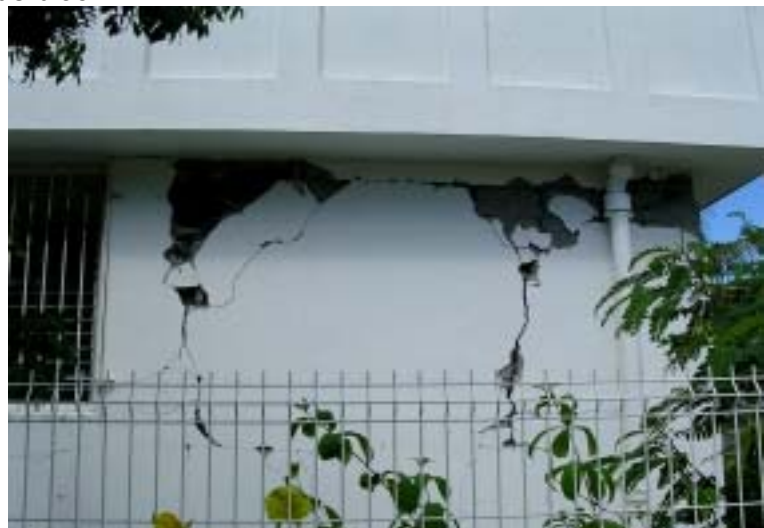
Hôtel de Ville de Terre de Bas, larges fissures sur les murs extérieurs
