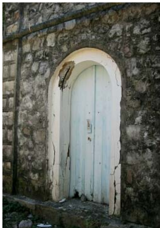
Fissures sur le porche de l'église
