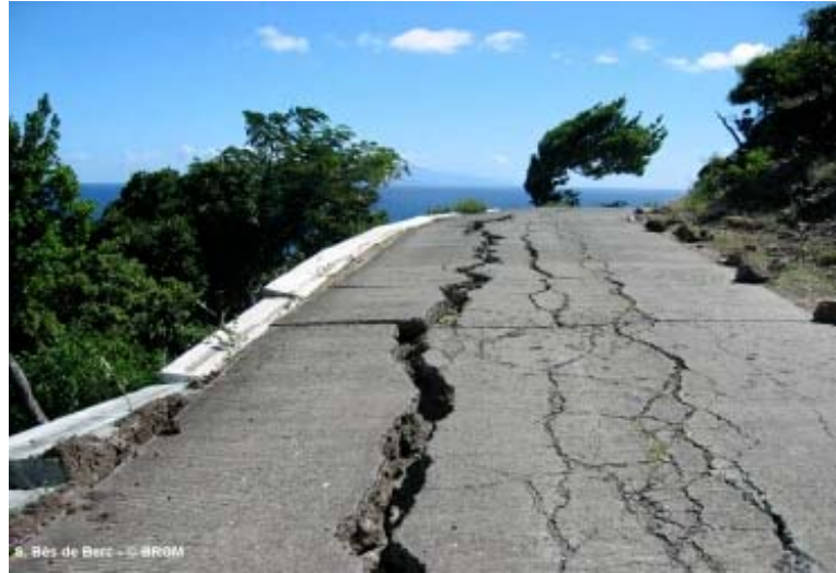
Dommmages sur la RD213, fissures sur la route
