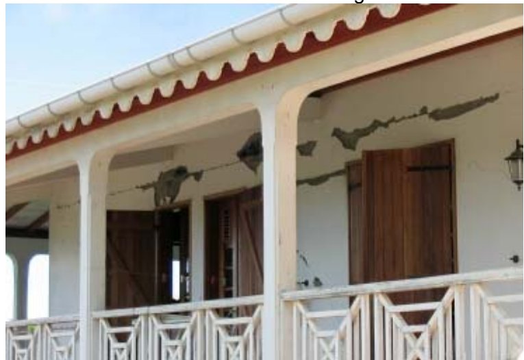
Dégâts sur une maison particulière au dessus du Pain de sucre
