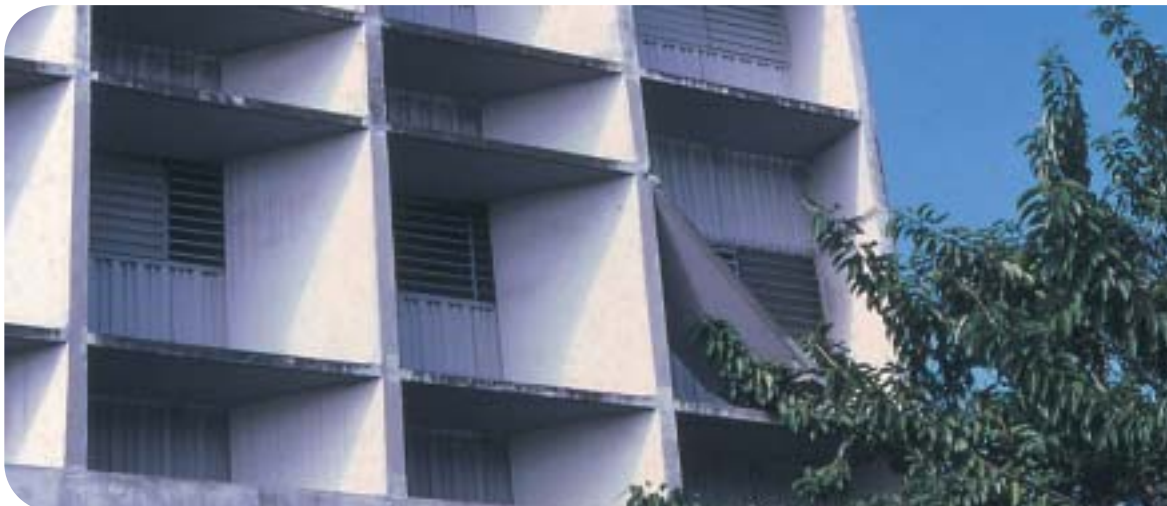
Dégradation de bâtiment à Pointe-à-Pitre après la secousse du 16 mars 1985.
