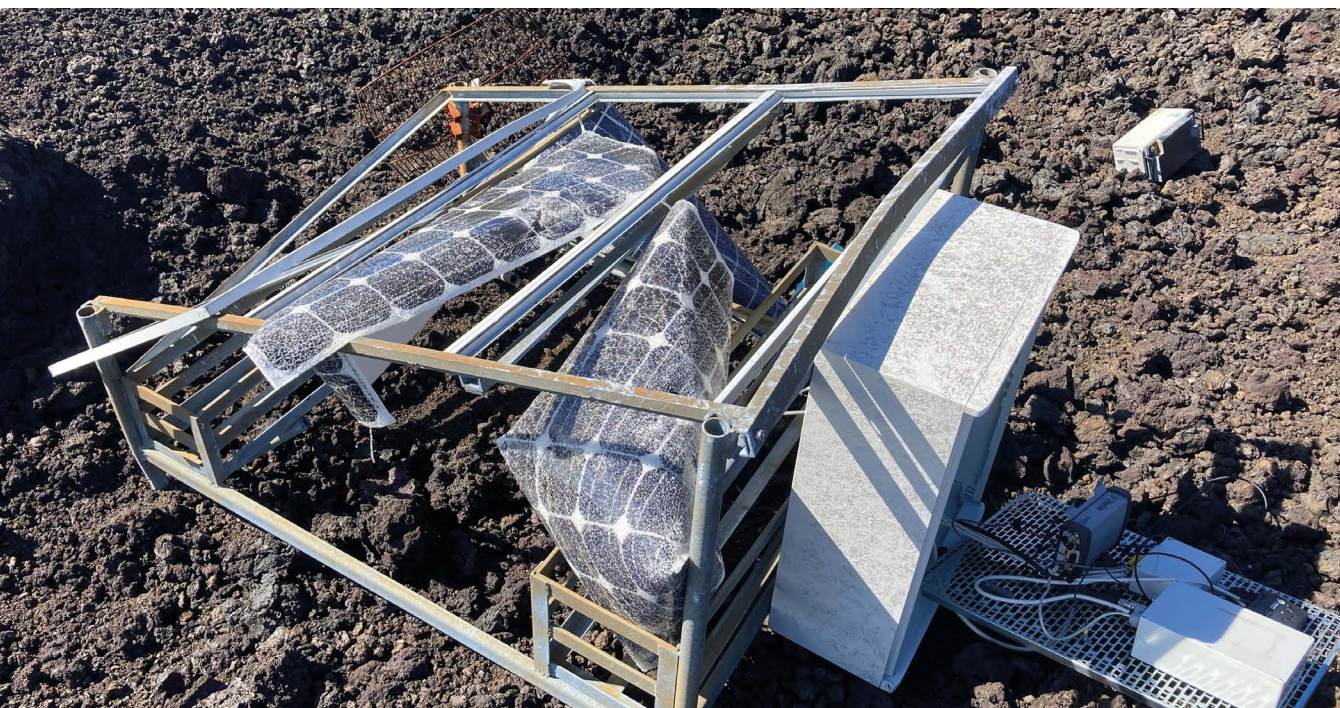
Station de l'OVPF-IPGP détruite par le passage du cyclone Belal au sommet du Piton de la Fournaise le 15/01/2024. OVPF-IPGP station destroyed by Cyclone Belal at the summit of Piton de la Fournaise on January 15, 2024.
