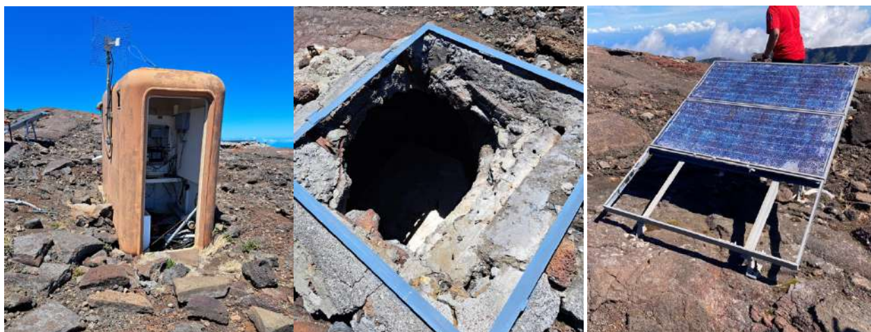
Figure 47 : Station BOR située au sud-ouest du cratère Bory suite au passage du cyclone Garance (photos du 5 mars 2025).
