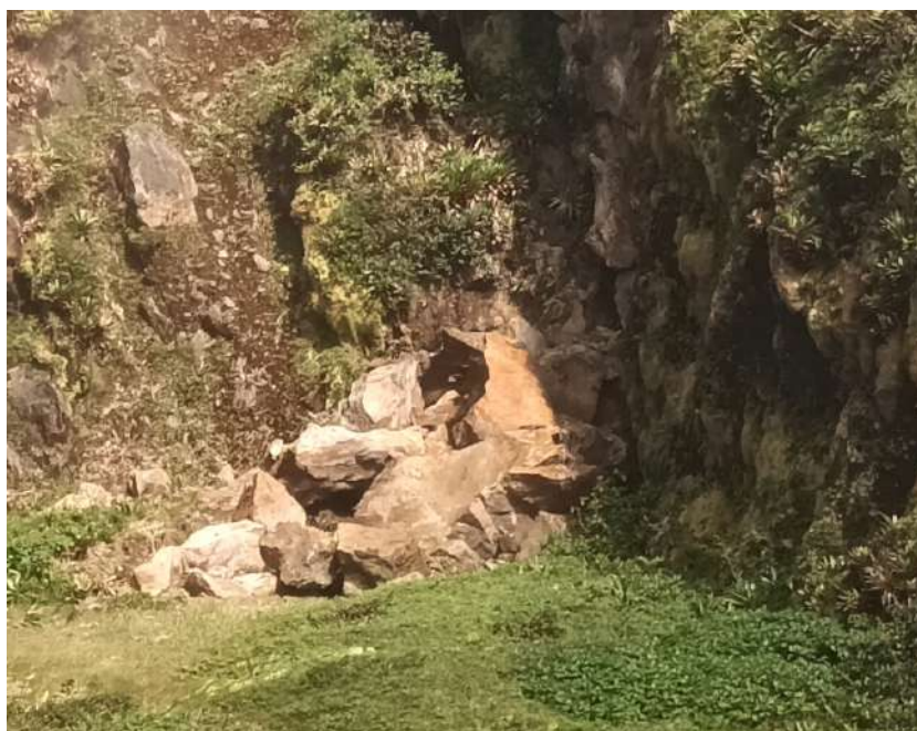
Figure 41. Effondrement dans le gouffre Dupuy. Un des crochets du site de mesure DUP2 était ancré sur un bloc effondré en décembre 2025.
