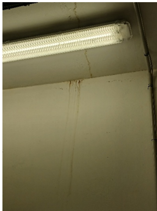
Figure 90 : Infiltration au-dessus de l'onduleur.
