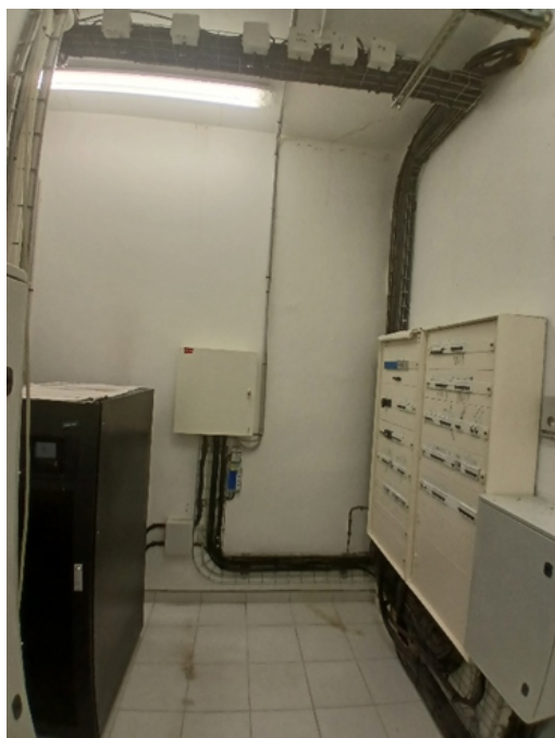
Figure 89 : Photo de l'onduleur et du TGBT.
